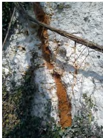
FIGURE 40 : EXEMPLE DE CONDUIT KARSTIQUE OBSTRUE DE LIMONS SUPERFICIELS
